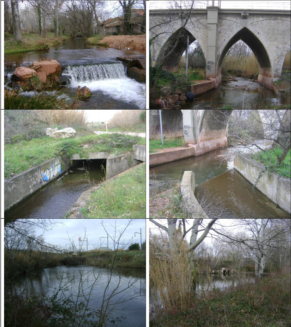
Au droit de l'ouvrage de la voie ferrée et bassin de rétention amont
