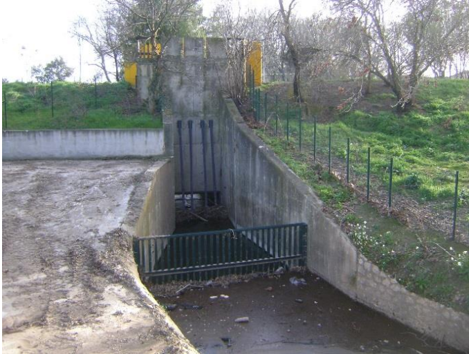
Figure 32 : Exemple d'ouvrage complexe - dégrilleur, vanne en sortie du parc du Griffon
