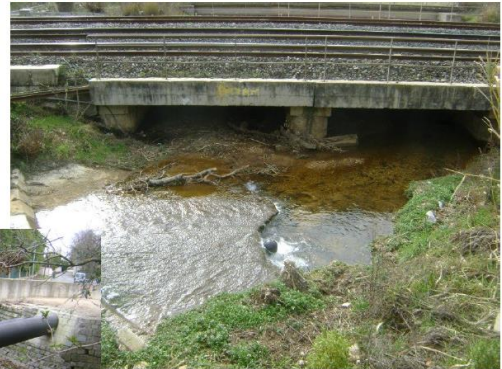
Réseau pouvant diminuer la section d'écoulement
